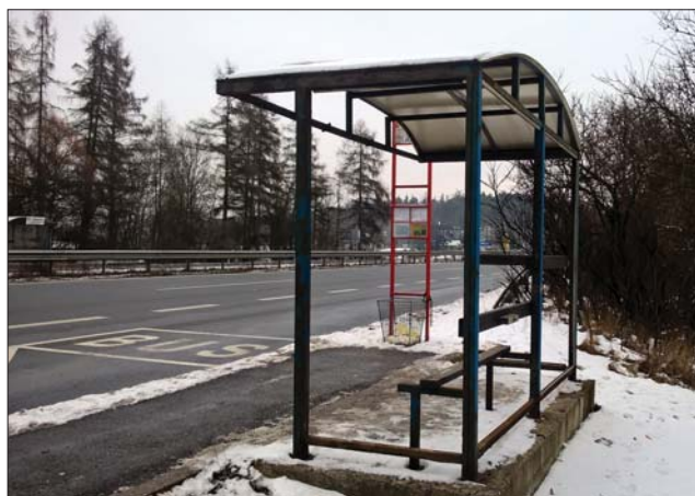
Stav čekárny před opravou v roce 2017
